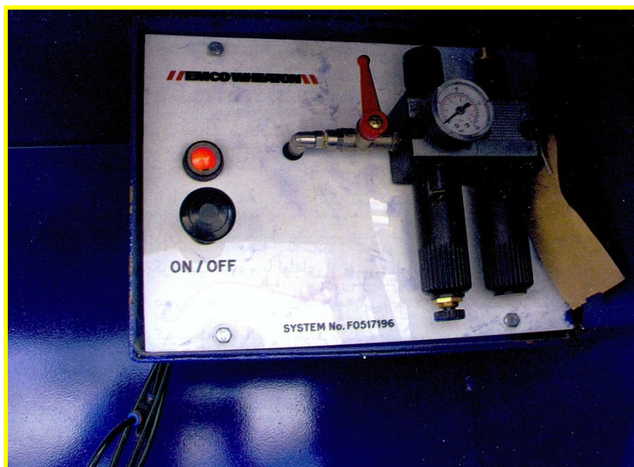
شکل ۷: تجهیزات اندازه گیری دما و فشار
